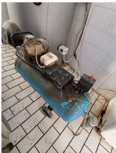
compressore matricola n. 0211
