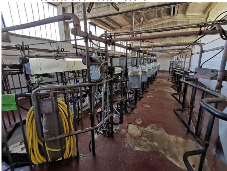
Sala mungitura: impianto di mungitura composto da 16 postazioni
